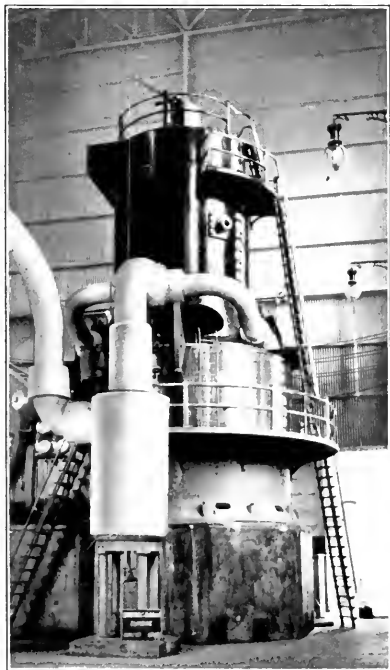
9000 K. W. Curtis Turbine.
